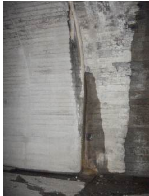
写真—25 福島側坑口から数十m、2番目の内巻箇所覆工コンクリート側壁部、漏水のある在来コンクリート（右）と補修後内巻コンクリート（左） （平成22年11月撮影）
