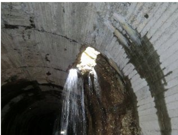
米沢側坑口覆工崩壊箇所 (伊藤弘治様 平成22年11月撮影提供)
