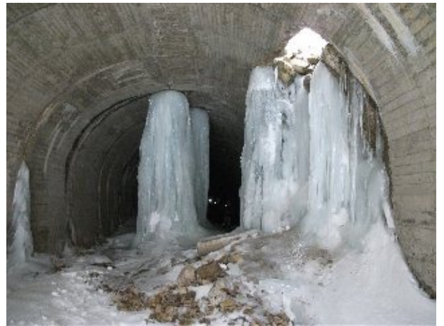
米沢坑口巨大氷柱
