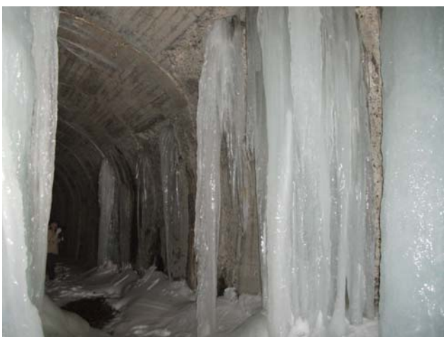
写真-14 米沢坑口巨大氷柱 (2)
