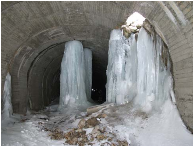
写真-12 米沢坑口巨大氷柱 (1)
