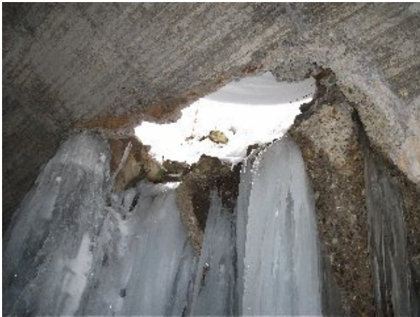
米沢坑口覆工崩壊箇所
