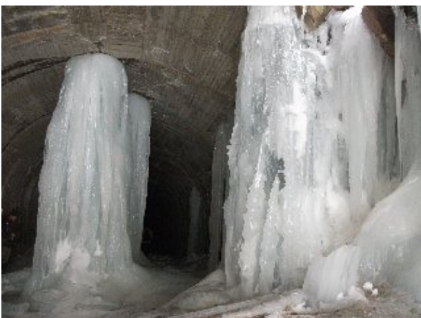
米沢坑口巨大氷柱
