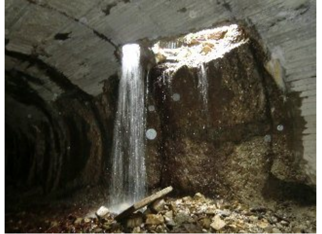
米沢側坑口附近、大崩落 (伊藤弘治様 撮影提供)
