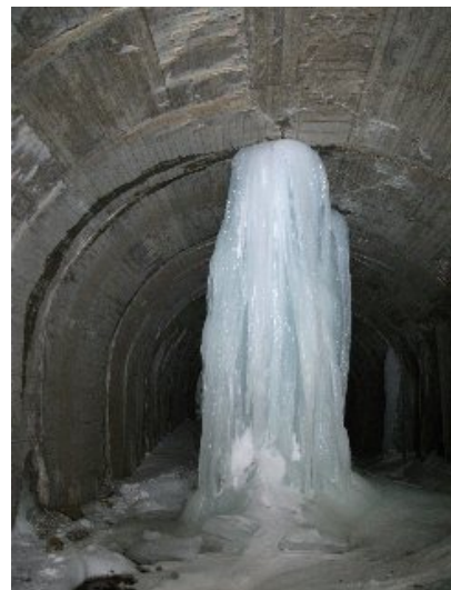
米沢坑口巨大氷柱
