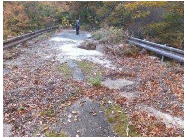
参考写真-2② 新沢橋上流側中央部付近に穴。 福島側(新沢左岸)から望む。 H301103
