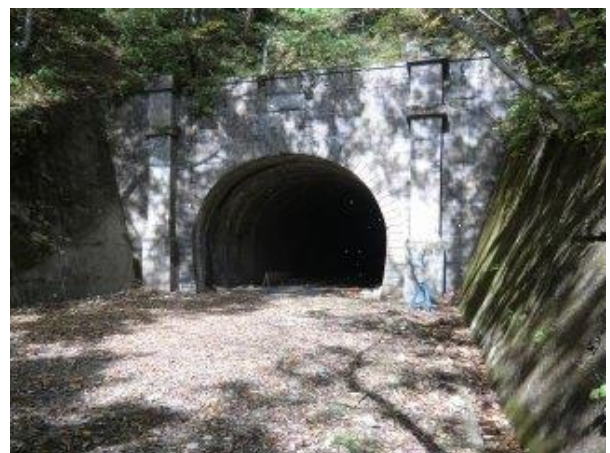
写真-5② ニツ小屋隧道（「昭和の大改修」2代目、L=384m、W=6.5m、S9.12完）福島側坑口。
