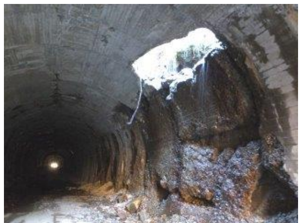
【写真-4②】 ニツ小屋隧道米沢側、覆工コンクリート(天井)崩落箇所。左側の光は福島側坑口。
