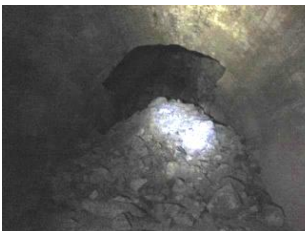
【写真-14④】 トンネル天井部崩落。 福島側から約 500m地点。
