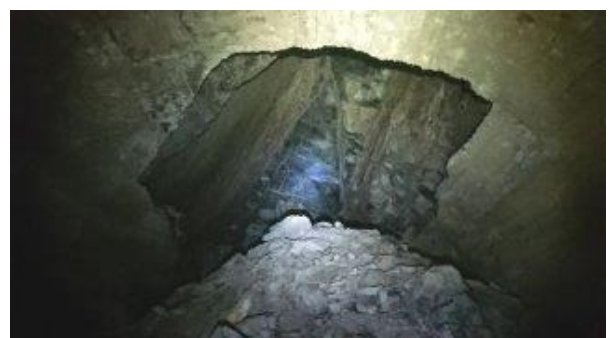
【写真-14⑤】 トンネル天井部崩落。 福島側から約 500m地点。 岡部達也様提供。
