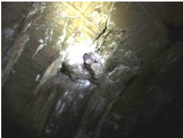
【写真-14②】 トンネル天井崩落箇所。 福島側坑口から約 200m付近。
