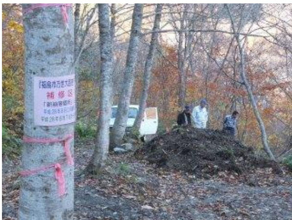
【写真-5②】 新崩落箇所(ニツ小屋隧道～烏川橋、 中間点)、平成 28 年 8 月 2 日豪雨に より道路崩落。米沢側を望む。
