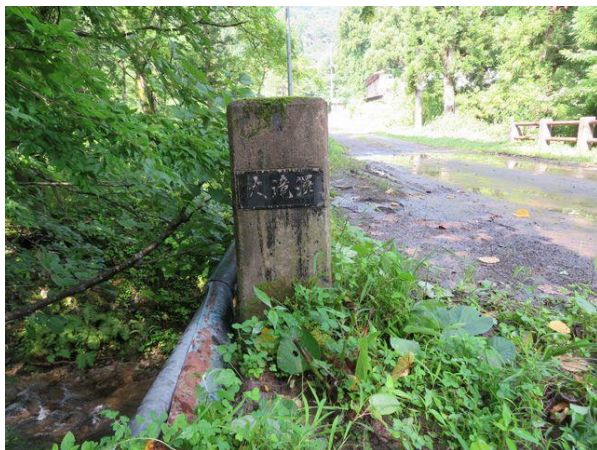
写真-14③ 発見:大滝橋福島側親柱(上流側)の 河川名が「大滝澤」に。 正しくは「大滝川」では。
