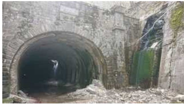
写真 16-4 米沢側坑口。覆工崩落箇所にも白竜沢の沢水が流れ込んでいるのが見える。
