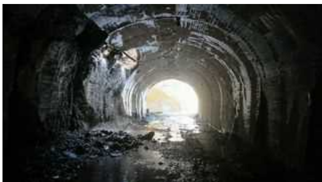
写真 17-1 米沢側坑口付近、覆工コンクリート崩落箇所の漏水。
