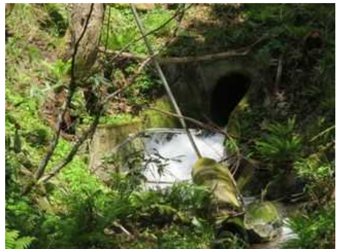
写真 12-2 せとの沢。雪解け水が流水多し。左側のコンクリート 柵箇所は、伝御膳水(天皇陛下のご用水)清水跡。
