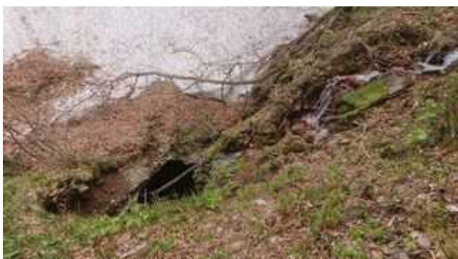
写真 17-3 覆工崩落箇所に流れ込む白竜沢(仮称)流水。
