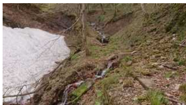
写真 17-4 白竜沢付替水路から溢水(水路閉塞か)。
