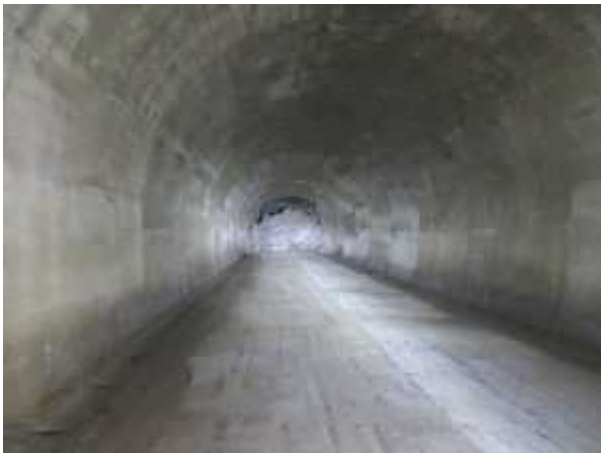
(写真-21①) 県境を過ぎると眼前に突然大崩落箇所が現れる。
