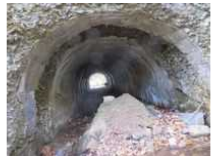
(写真-15⑥)。 吐き口部一部崩落。
