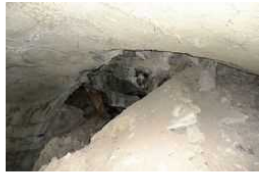
(写真-23②) 崩落箇所左側。米沢側からも覆工破断面を見ることができず、崩落土が破断面を覆っているのが確認される。従って当該箇所は福島側の奥の大崩落箇所と同一箇所ではないかと推定される。同左 提供 H210315
