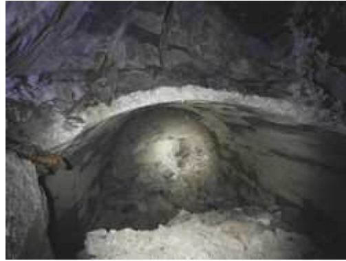
(写真-20②) 平成 28 年 6 月 手前の大崩落箇所から 奥(米沢側) の崩落も確認。 同左 提供 H280626
