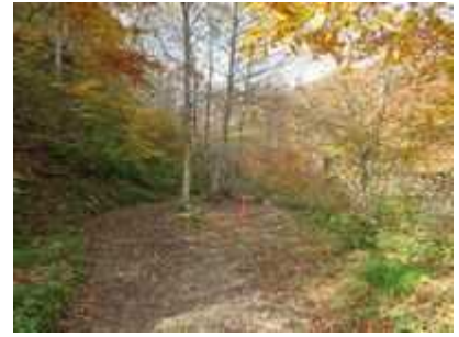
(写真-5③A) ニツ小屋隧道・米沢側坑口から 百数十m付近、道路崩壊箇所 (H28.8.4 豪雨で不通)福島側から 望む。ボランティアにより左側に 迂回路確保。
