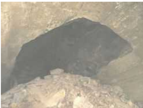
(写真-21③) 手前の大崩落箇所天井部、福島側から望む。
