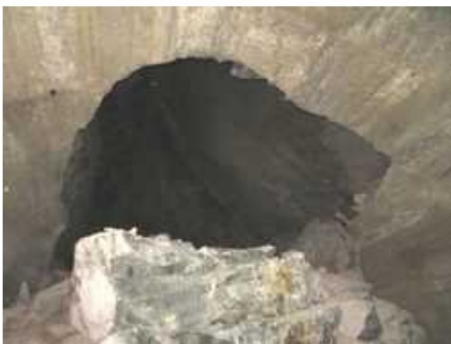
(写真-21⑨) 手前の大崩落箇所、天井部を米沢側から望む。
