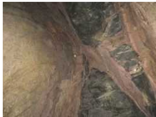
(写真-21④) 手前の大崩落土石堆積頂上から崩落天井を望む。
