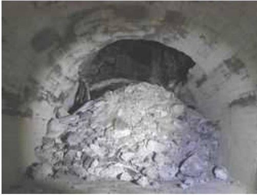
(写真-20①) 平成 28 年 6 月 手前の大崩落箇所。 dark-RX 様提供 H280626
