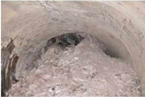
(写真-23①) 米沢側大崩落箇所を望む。 おばら様提供 H210315
