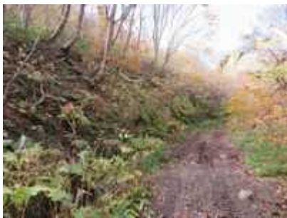
(写真-12⑦) 第5段目道路中間部の石積、4号カーブ側(福島側)から5号カーブ側(米沢側)を望む。
