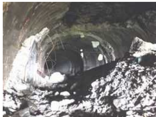
(写真-23④) 崩落箇所から奥(福島側)を望む。当該箇所は、内巻(鉄筋入り)補修区間と思われ、在来覆工コンクリートと共に崩落している。 H281011
