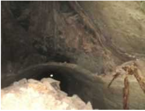
(写真-21⑤) 手前の大崩落土石堆積頂上から崩落箇所福島側 覆工破断部・崩落面を望む。白点は、福島側坑口。
