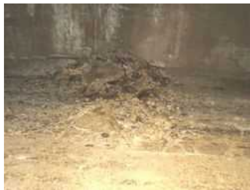
(写真-18 ④) 奥の小崩壊箇所。崩落土石。 R031016
