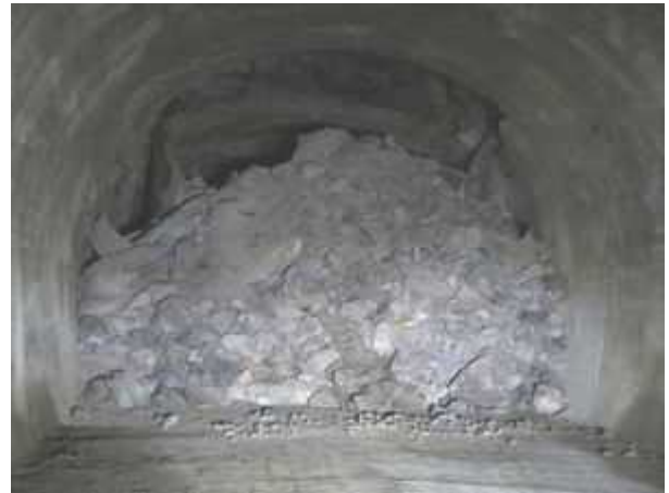
(写真-21②) 手前の大崩落箇所、福島側から望む。
