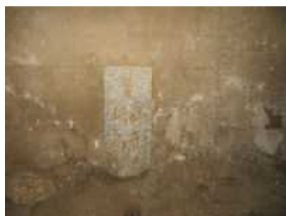
(写真-19 ①) 福島・山形県境標石(左側)。 福島県分左側坑口まで L=453m。 栗子隧道 L=870m。
