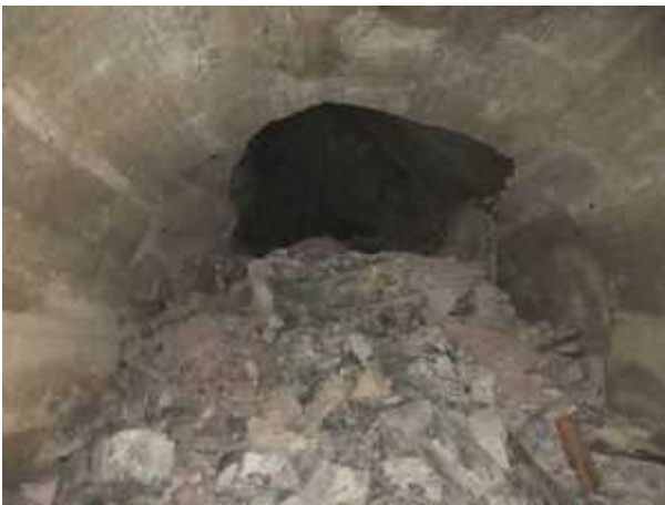
(写真-21⑦) 手前の大崩落箇所、米沢側から望む。
