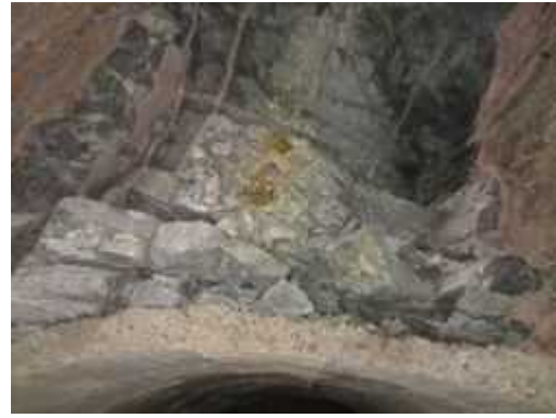
(写真-21⑥) 手前大崩落土石堆積部頂上から崩落箇所米沢側 覆工破断部・崩落面を望む。(写真-20②)参照。
