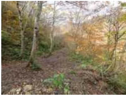
(写真-5④) 道路崩壊箇所付近から烏川橋方向 (米沢側)を望む。
