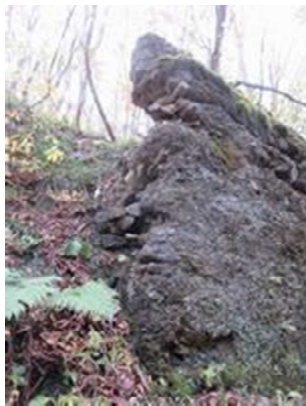
(写真-14⑩) 福島側橋台端部(下流側)。 コンクリートは表面だけのように見える。
