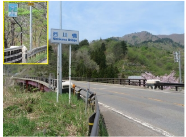
(写真-15④) 現国道 13 号現橋西川橋(3代目)、福島側から望む。 標高 400m。
