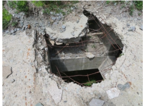
(写真-25②) 床版崩落箇所
