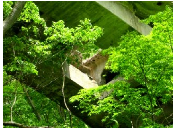
(写真-25④) 下から望む床版崩落箇所。
