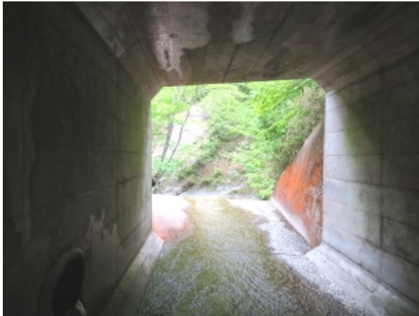
(写真-26③) 新沢カルバート(ボックスカルバート部)吐口、 内側から下流部を望む。
