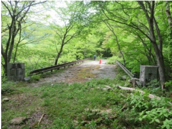
(写真-25①) 現在廃道、新沢橋(第3代)、福島側から望む。 写真中央赤色セーフティコーン箇所 に穴あり(床版崩落箇所)。
