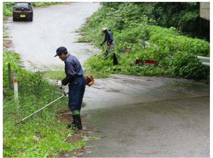
写真-13② 大滝集落入口 国道13号大滝橋 アンダーパス箇所除草。
