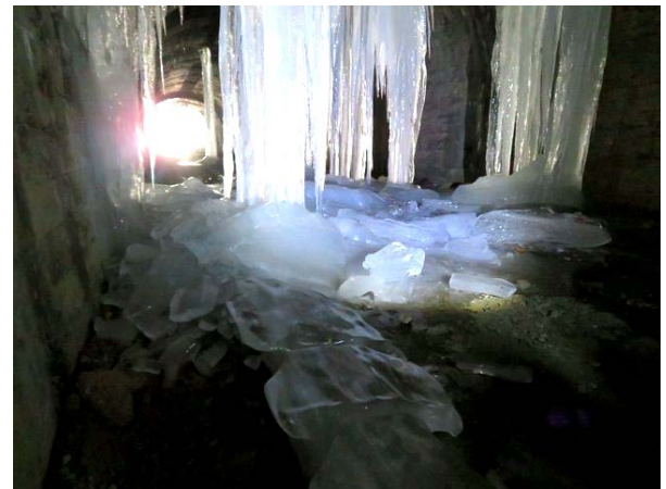
写真 12-2 北側(左端)及び中央氷柱背面の足元。 米沢側から望む。
