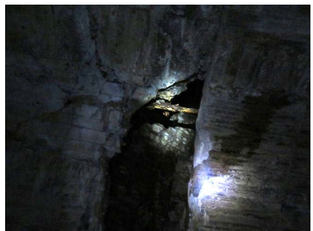
写真 14-1B 天頂部覆工(巻立)コンクリート崩壊箇所、写真 1A 箇所を真下から見たもの。第 4 号内巻区間米沢側端部。R021105
