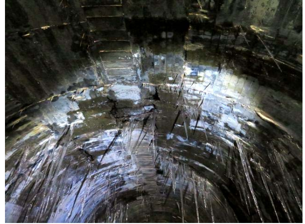
写真 13-2B トンネル天井部、写真 2A 箇所付近。 平常時期の状況、水が滲出している程度。 コンクリートが剥落、剥き出しの鉄筋は 写真 2A と同一のもの。R021105
