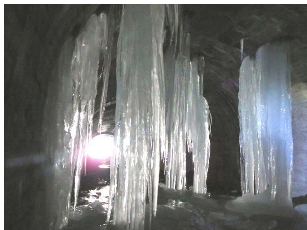
写真 11-2 南側氷柱(写真右)も角度を変えてみると 吹き出し口が2箇所になっている。
