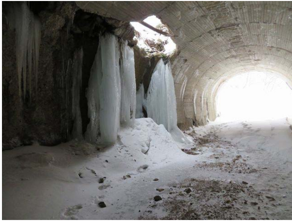
写真 15-1A 米沢側坑口左側の氷柱群 (覆工コンクリート崩落箇所)。
