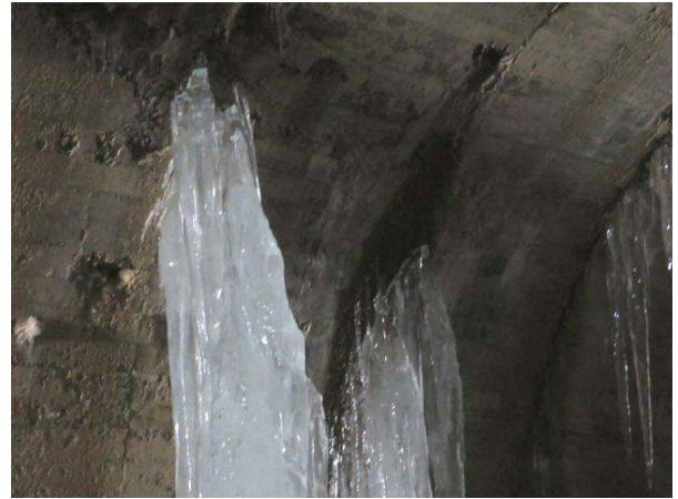
写真 6-4 氷柱発生部、右側の氷柱の上から湧水。
