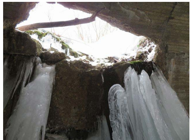
写真 15-5 巨大氷柱群吹き出し口。 覆工コンクリート崩落箇所から外を見る。
