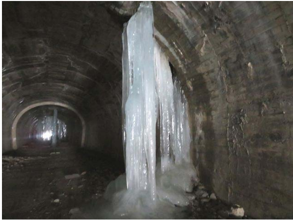
写真 7-1 第 2 番目氷柱群、第 1 号内巻区間米沢側端部 右側。奥に第 2 号内巻区間が見える。 門番のような氷柱が真ん中にあり、その背後 に巨大氷柱群。福島側から望む。
