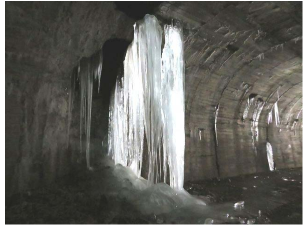
写真 7-2 米沢側から望む氷柱群。 氷柱左側は巻立コンクリート(覆工)崩壊箇所。
