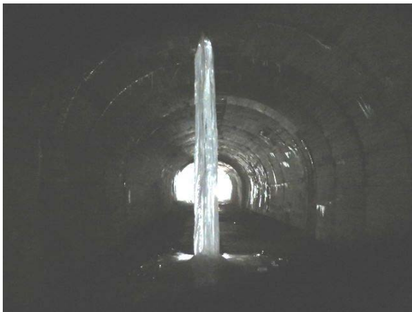
写真 8-3 第 2 号内巻箇所、門番氷柱を米沢側から望む。
