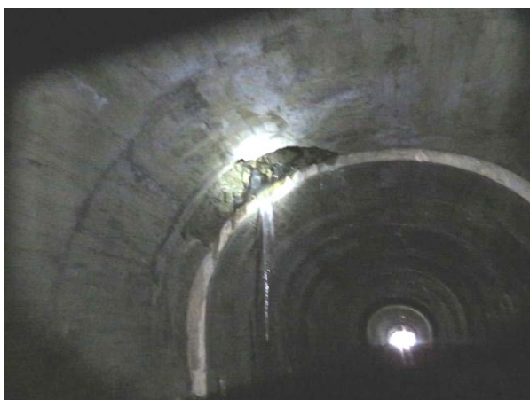
写真 14-1A 覆工(巻立)コンクリート崩壊箇所のつらら、下に氷筈。第 4 号内巻箇所米沢側端部。米沢側から望む。
