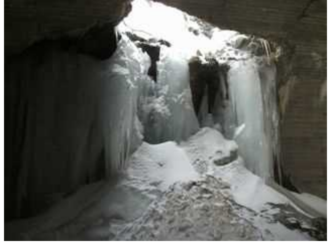
(写真 24・4-4) 覆工コンクリート崩落箇所。
