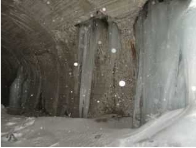
(写真 24・4-3) 覆工コンクリート崩落箇所 の福島側。
