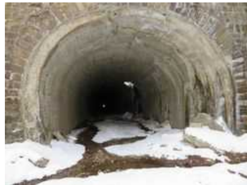
参考写真No.2 二ツ小屋隧道米沢側坑口・内巻端部(崩落状況)。 第6号内巻(坑口から約80m区間)。 R020119
