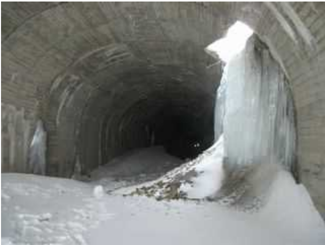
(写真 24・4-5) 米沢側坑口付近から福島側を望む。 右上覆工コンクリート崩落箇所。
