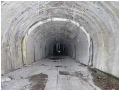
参考写真No.1 二ツ小屋隧道福島側・内巻箇所。 第1号内巻(坑口から約20m地点、約30m区間)。 米沢側を望む。H310114
