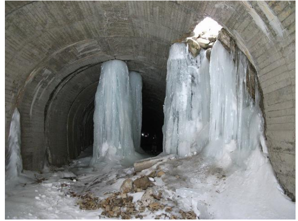
【参考写真-2】 平成 23 年 2 月(大震災 1 ヶ月前)、米沢側坑口に発生した巨大氷柱(中央部)。写真-15③箇所 H230206
