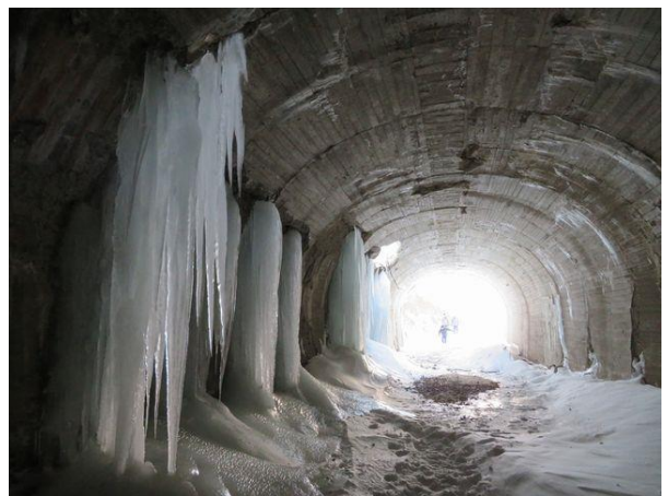
写真-15① 米沢側坑口を坑内より望む。 左側巨大氷柱群。
