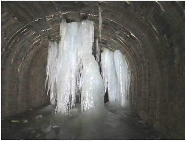
写真-10② 中間部の巨大氷柱群、 福島側から望む。(2)
