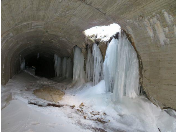
写真-15③ 米沢側坑口付近 巨大氷柱群全景、米沢側から望む。
