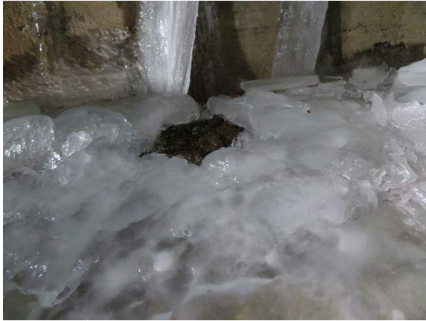
写真-7④ 最初の氷柱群足元、漏水が流れ出ていた。
