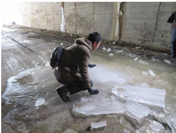
写真-6③ 入口の落下氷柱
