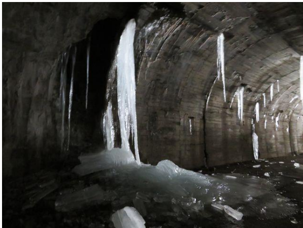
写真-8② 福島側坑口からから2番目の氷柱(右側)、米沢側から望む。
