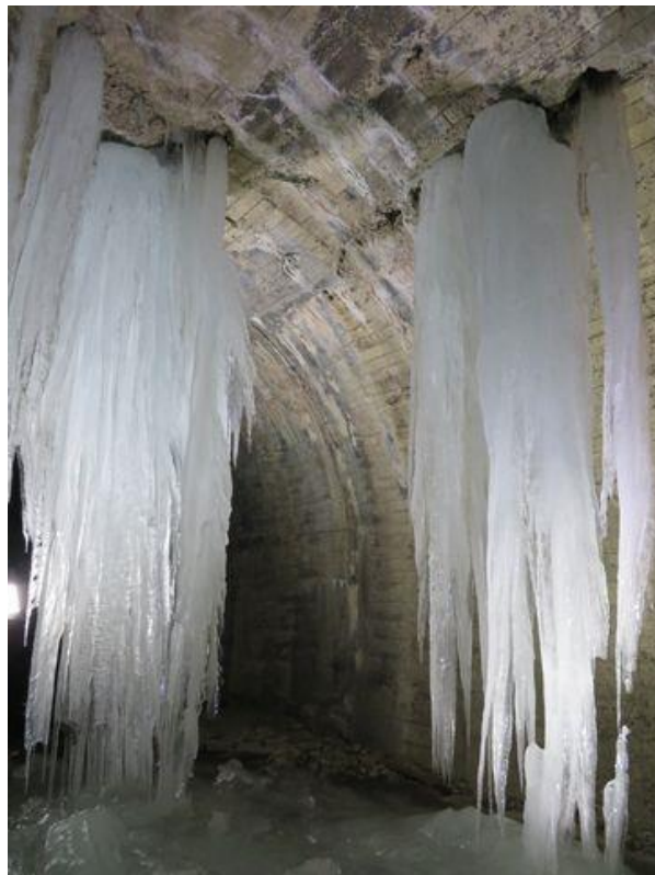
写真-13③ 中央部と南側の巨大氷柱、米沢側から望む。
