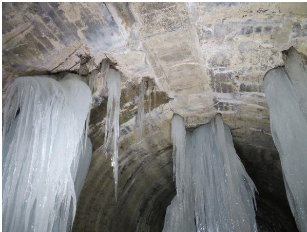
写真-14① 中間部の巨大氷柱群、天井部。
