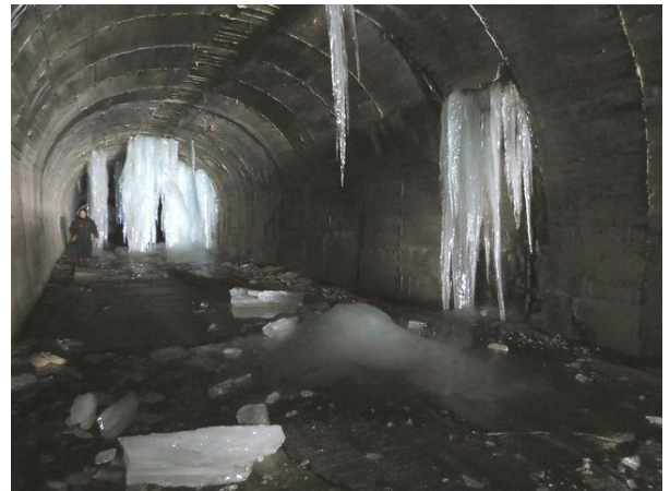
写真-9① 福島側坑口から3番目の氷柱群(右側)、福島側から望む。左奥は中間部の巨大氷柱群。
