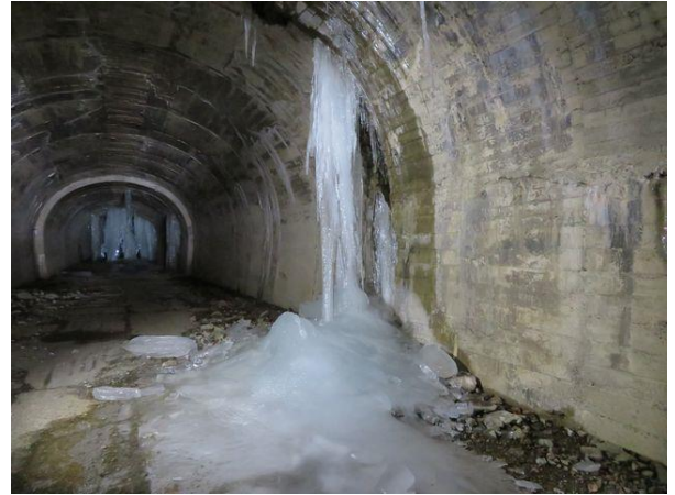
写真-8① 福島側坑口からから2番目の氷柱(右側)、福島側から望む。奥に巨大氷柱群。
