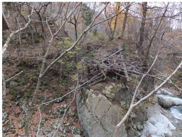
写真-15② 対岸左岸の橋台部及び上部工の部材が残存。その奥に左から右へ道路が見える。
