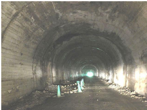
写真-13② 隧道中央部崩落箇所。米沢側から福島側 を望む。
