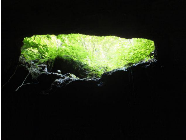
写真-13④ 天井崩落箇所(トンネル覆工コンクリートアーチ部)。
