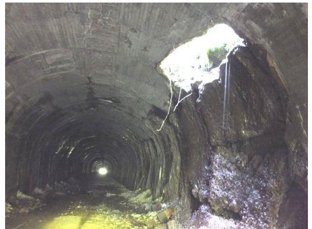
写真-13③ 天井崩落箇所(トンネル覆工コンクリート アーチ部)。 米沢側坑口から福島側を望む。
