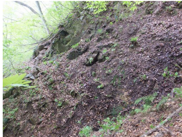
写真-12② 沢右岸を左岸蛇体道から望む。左側奥に残存蛇体道が見え、続くはずの手前の道は消滅急崖となっている。クビト峠方向を望む。
