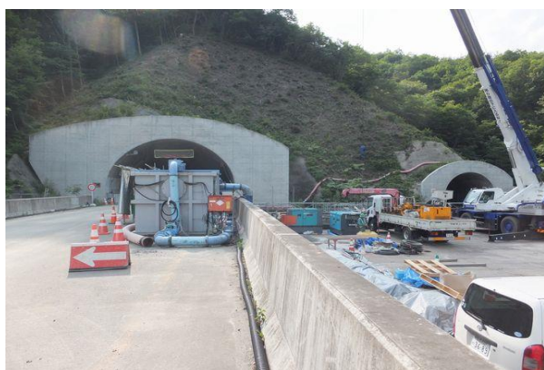
参考写真-2① 東北中央自動車道(E13)新西川橋(4代目)橋上から新栗子トンネル(L=8,972m)福島側坑口を望む(右は避難用トンネル)。H290629
