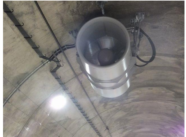
【写真-4③】 中心部近く、ジェットファン1基のみ 設置。
