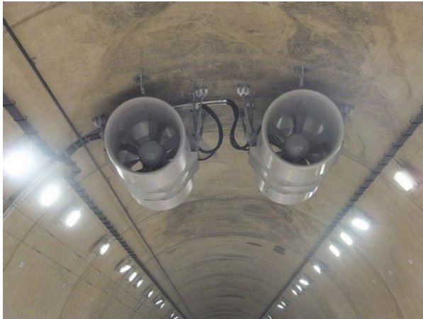
【写真-4②】 ジェットファン2基並列設置
