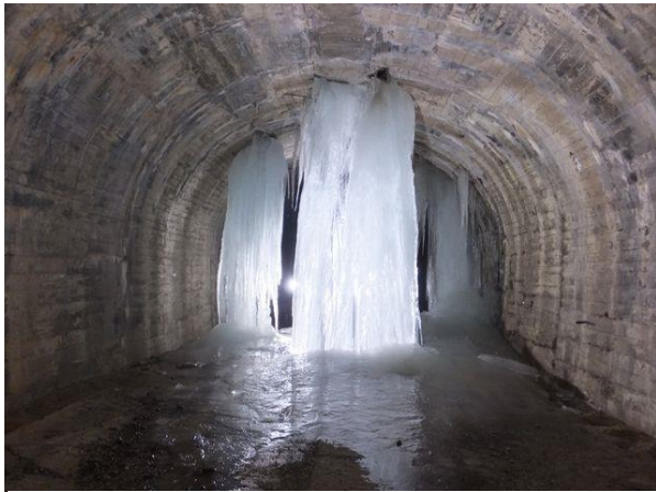
写真-4① 中間部巨大氷柱、福島側から望む(1)。
