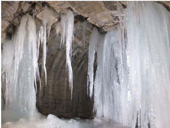
写真-8① 中間部巨大氷柱天井部、米沢側から望む(1)
