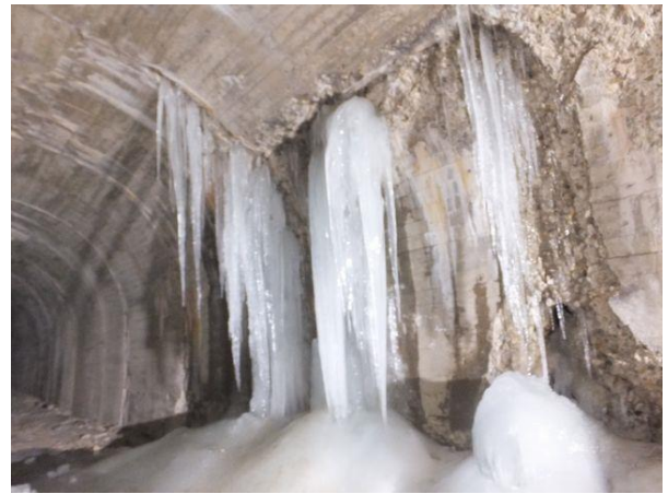
写真-10② 米沢側坑口付近巨大氷柱群(2)。
