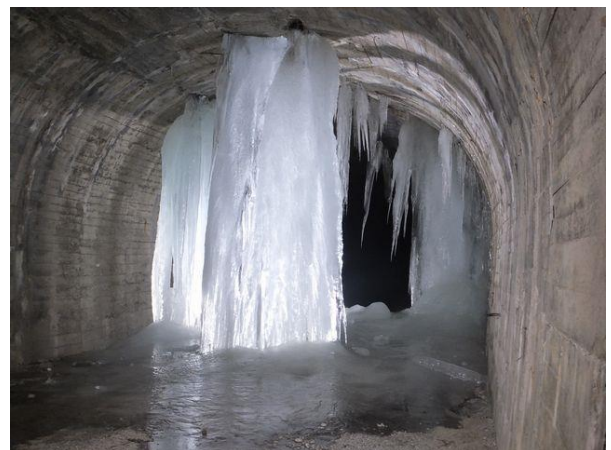
写真-4④ 中間部巨大氷柱群、福島側から望む(4)。
