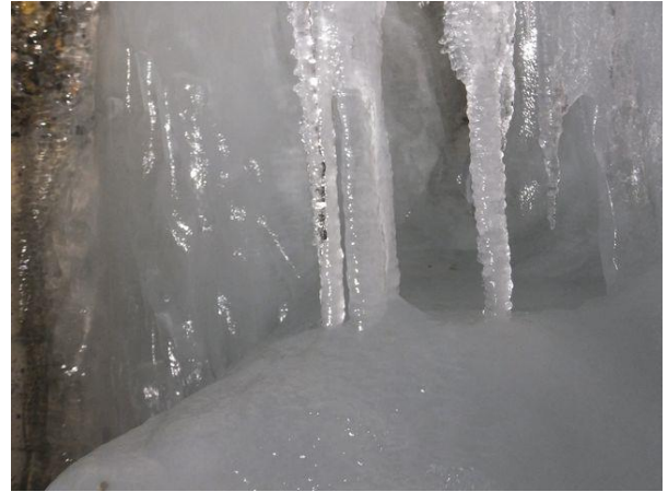
写真-9② 中間巨大氷柱、米沢側から望む。 漏水滴り落ちる。
