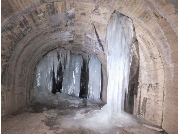
写真-5① 中間部巨大氷柱、米沢側から全体を望む(1)。
