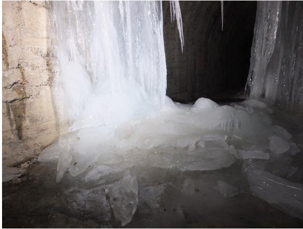
写真-9① 中間巨大氷柱、米沢側から望む。 向かって左側氷柱足元。
