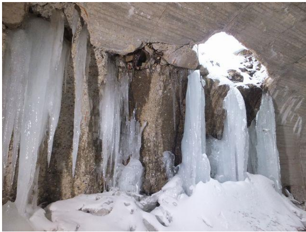
写真-10① 米沢側坑口付近巨大氷柱群(1)。
