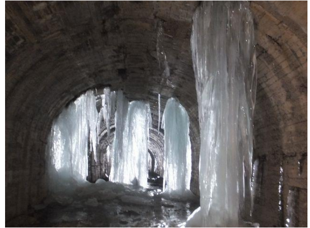
写真-5② 中間部巨大氷柱、米沢側から全体を望む(2)。
