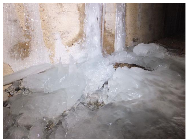
写真-2③ 福島側最初の氷柱群
