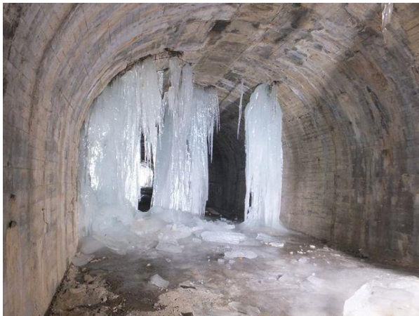
写真-6① 中間部巨大氷柱、米沢側から望む(1)
