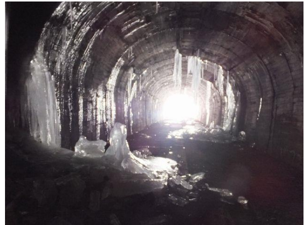
写真-4③ 2番目氷柱群から福島側坑口を望む。
