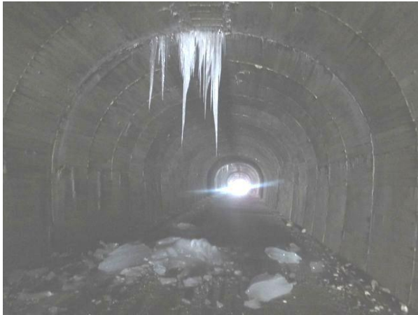
写真-8① 巨大氷柱落下(米沢側)
