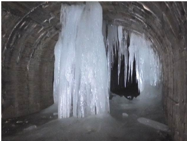
写真-6② 中間部巨大氷柱群、米沢側を望む。
