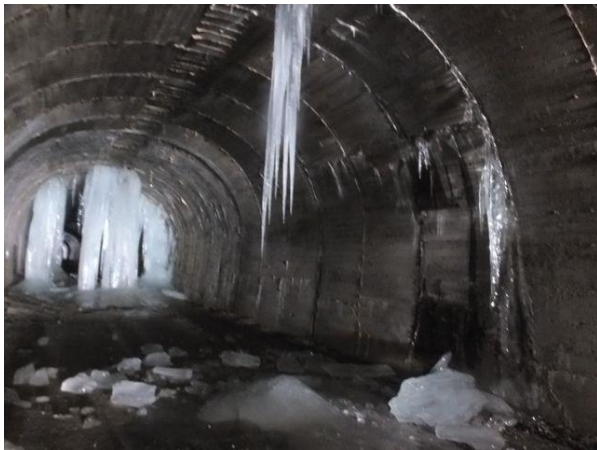
写真-5① 福島側(右)から3番目氷柱群、氷柱落下。
