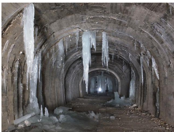
写真-2 福島側氷柱群、米沢側を望む。
