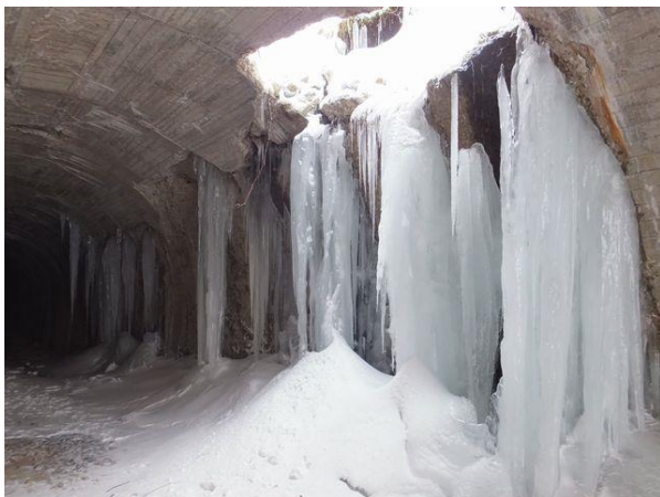
写真-9③ 米沢側坑口水柱群(覆工崩落箇所)
