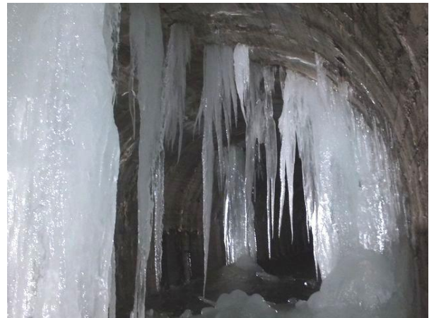
写真-6③ 中間部巨大氷柱群、米沢側を望む。
