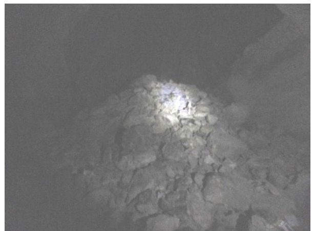
写真-8⑦ 大崩壊箇所(福島側から 500m付近)
