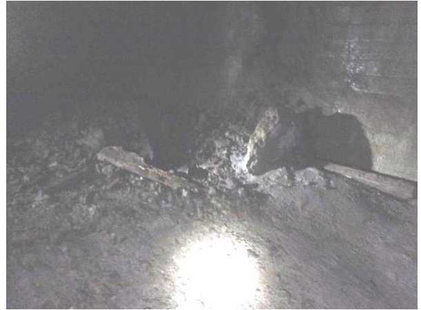
写真-8⑤ 崩落土石コンクリート(木材)
